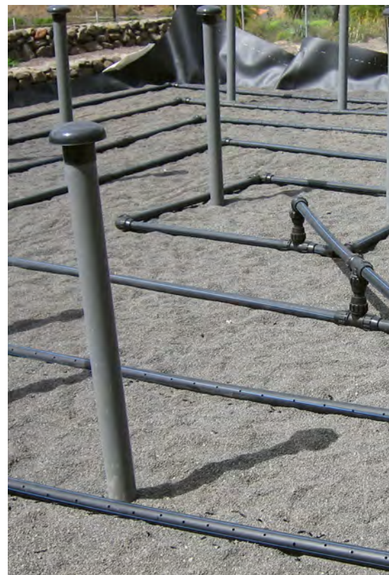
Humedal de flujo vertical Mancomunidad del Sureste de Gran Canaria
